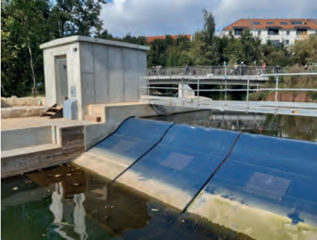
Die einstellbare Wellenrampe mit ihren drei Modulen, links das Maschinenhaus, wo sich auch - hinter dem kleinen Türchen - der Not-Aus-Schalter befindet.
